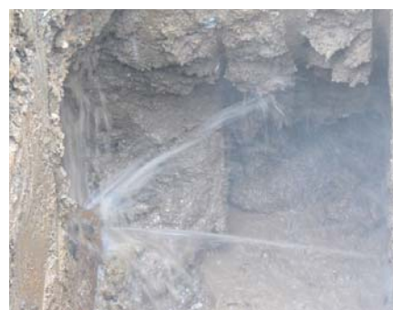
Prasklé potrubí v ulici Na Terase 23. 1. 2016
